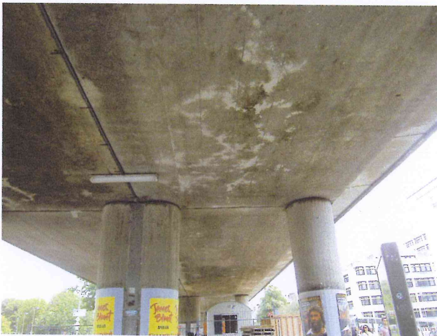
Aussinterungen an der Brückenunterseite
