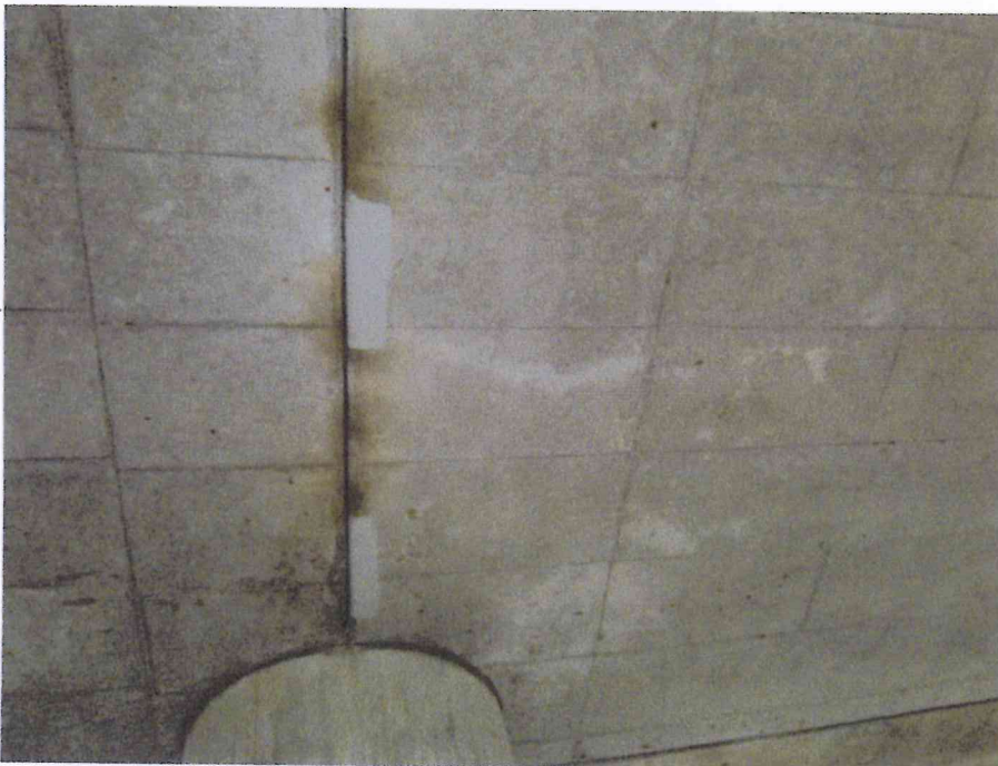
Instand gesetzte Endverankerungen mit Längsriss (Haarriss)
