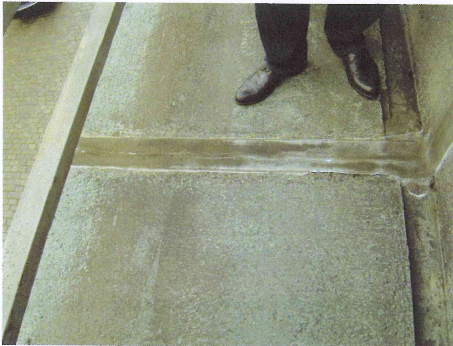
Schadhafte Fugenabdichtung auf der Bürckenoberseite
