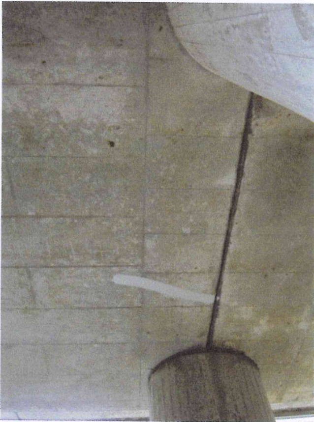
Instand gesetzter Längsriss
