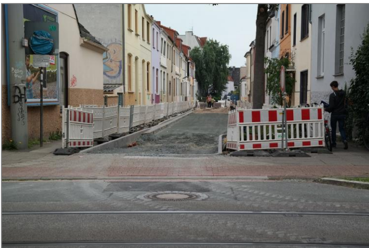
Abbildung 41: Gehwege sind durch Baustelle stark verengt (Quelle: Eigenes Foto)
