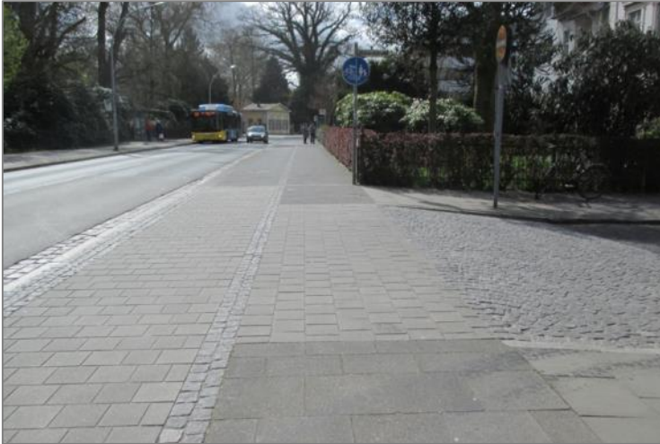
Abbildung 11: Gutes Beispiel für eine Einmündung mit Leitlinie durch Großpflaster (Quelle: Eigenes Foto)
