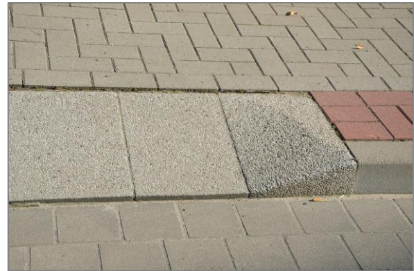
Abbildung 5: Schrägbordstein in Nahaufnahme (Quelle: Eigenes Foto)
