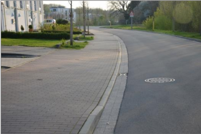
Abbildung 2: Beispiel für starke Querneigung an Grundstücksüberfahrt (Quelle: Eigenes Foto)
